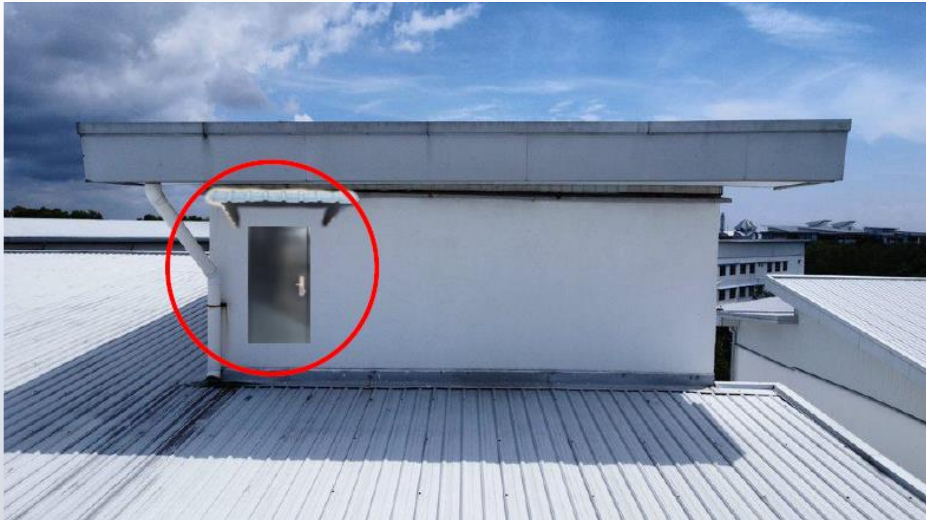
Access Door (FKM Blok Pentadbiran)
